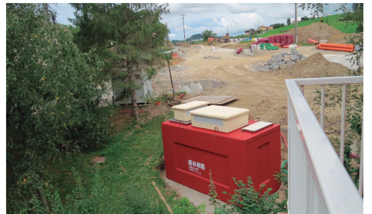
Transformadorea, etxebizitza batetik ikusita. TXINTXARRI
