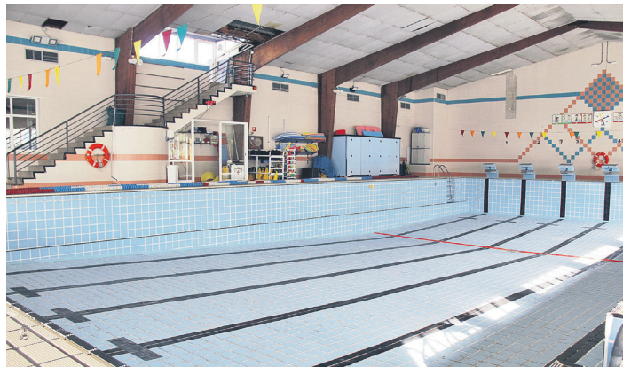
Sabai aizuneko plakak erori eta estrukturako arazoa agerian geratu da. TXINTXARRI
